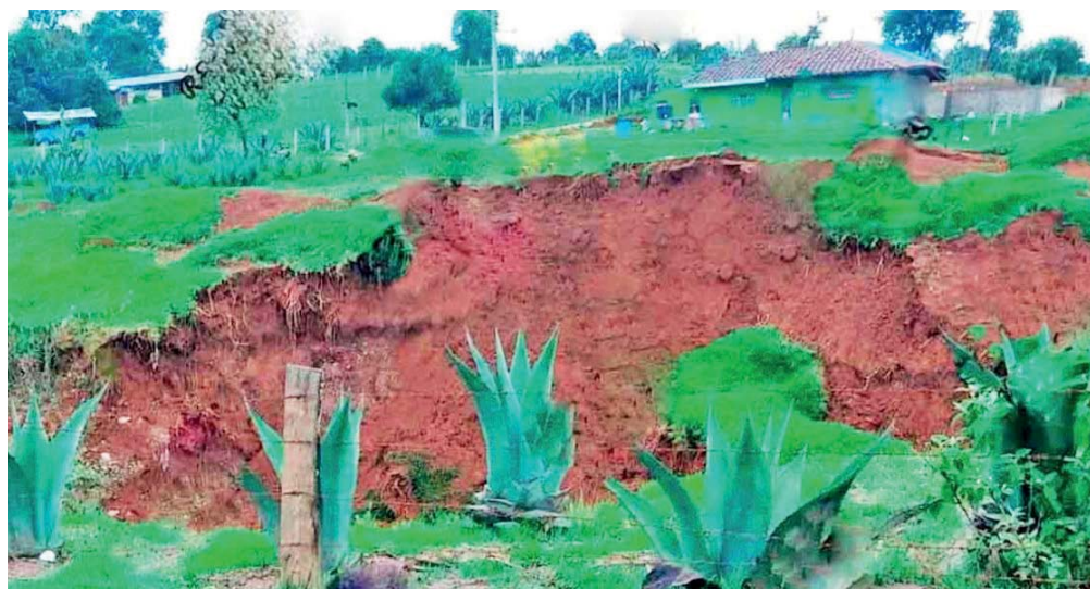
por las fuertes lluvias y por la filtración de humedad, el diámetro del pozo creció, pues en un principio era de 5 metros, actualmente tiene 15 metros de diámetro y 2 de profundidad. FOTO: ENFOQUE
