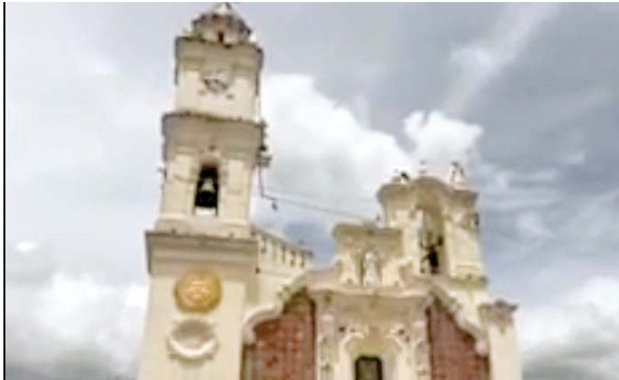
UNA DE LAS CINCO IGLESIAS más dañadas durante el sismo de S-19
